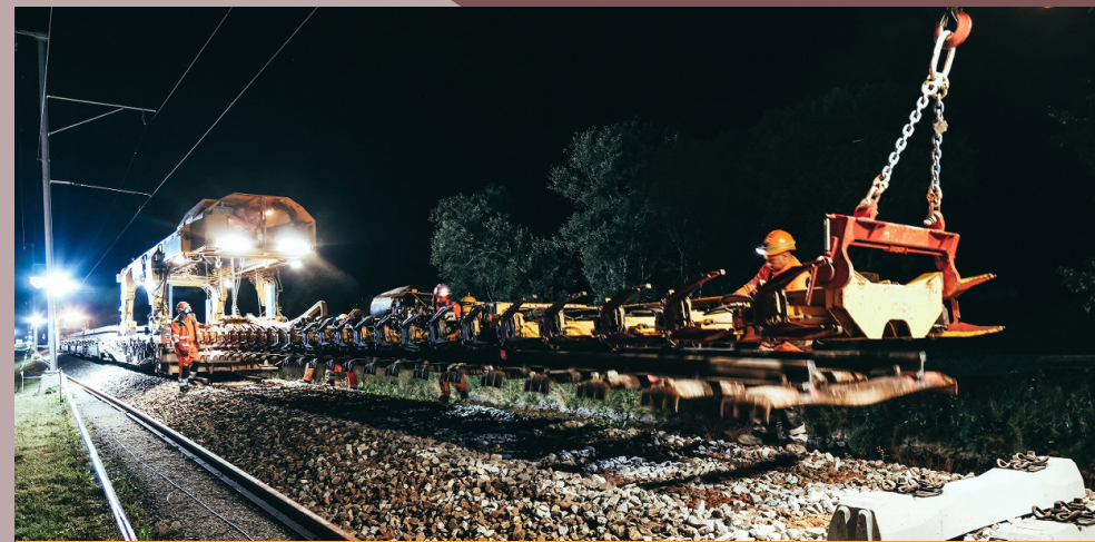
Mithilfe des «Schnäggs» (rechts) wird ein altes Stück Gleis auf den «Mungg» (langes Fahrzeug, links) aufgeladen.
